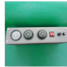
Panou comandă și control
